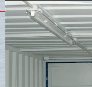
Leuchtbalken und Zugschnurschalter
